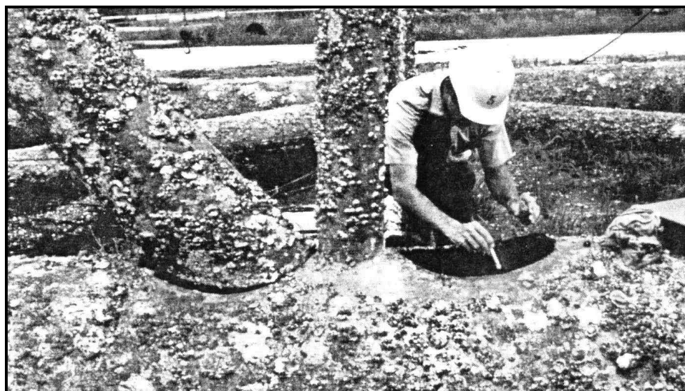
Figura 2.1 – Exemplo de Falha em Juntas Soldadas.
